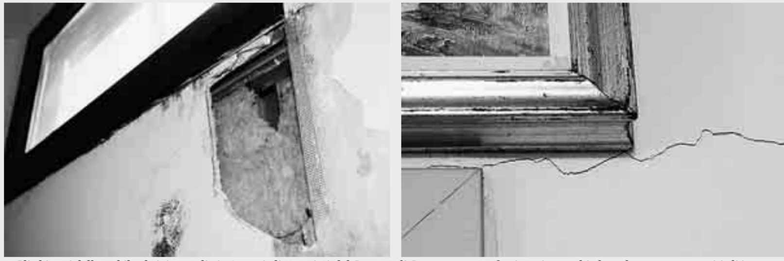
Gli abitanti dello stabile al civico 37 di via Anzani, di proprietà del Comune di Como, tornano a farsi sentire e a chiedere che vengano eseguiti gli interventi necessari per mettere in sicurezza l'edificio dove risiedono un'ottantina di famiglie: nei muri si aprono crepe e l'ascensore è spesso guasto (foto Pozzoni)
